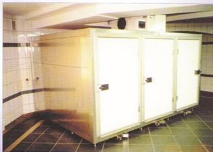
Komora chłodnicza na 6 ciał (uniwersalnie w trumnach lub na tacach), w systemie regałowym, cmentarz komunalny w Słupsku.
